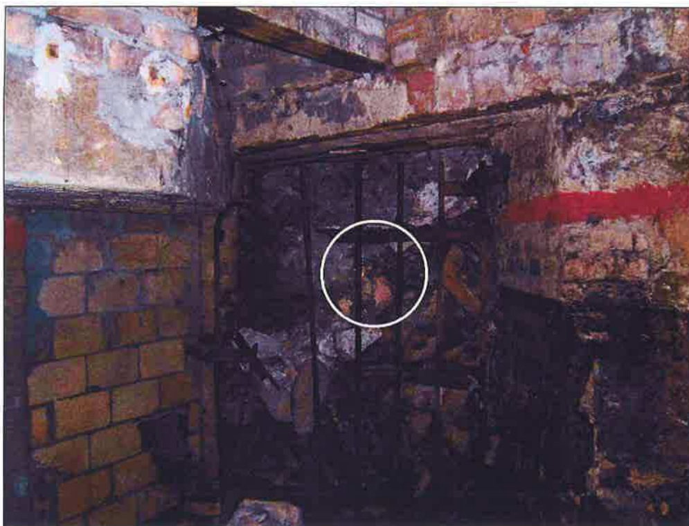
Foto 3: Sammler 3, Heizungskeller (Geb. 2), Südseite. Der Sammler wurde an der verschütteten Tür (?) befestigt.
