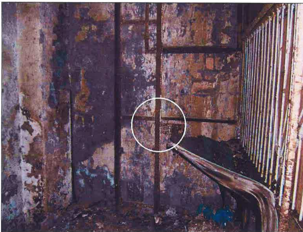
Foto 1: Sammler 1 in Aufzugsschacht Gebäude 3
