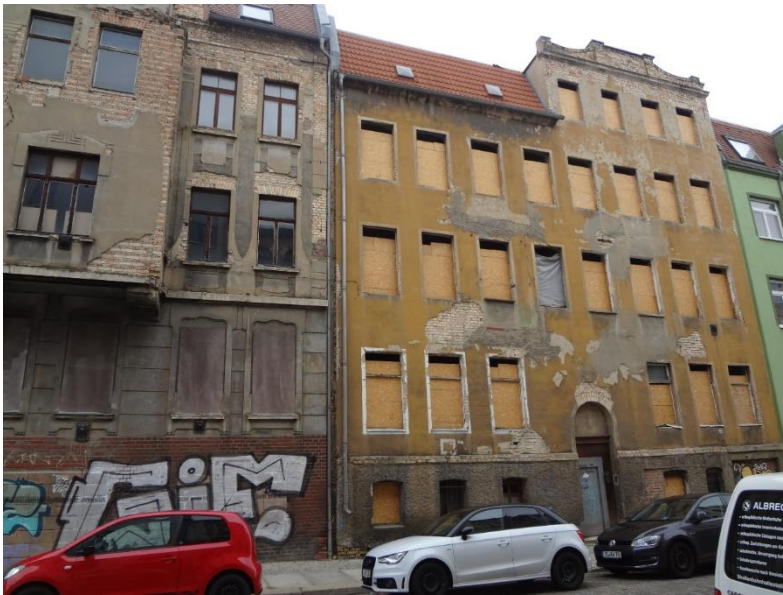
Abbildung 19: Sanierungsbedarf an historischen Gebäuden, Quelle: cK
