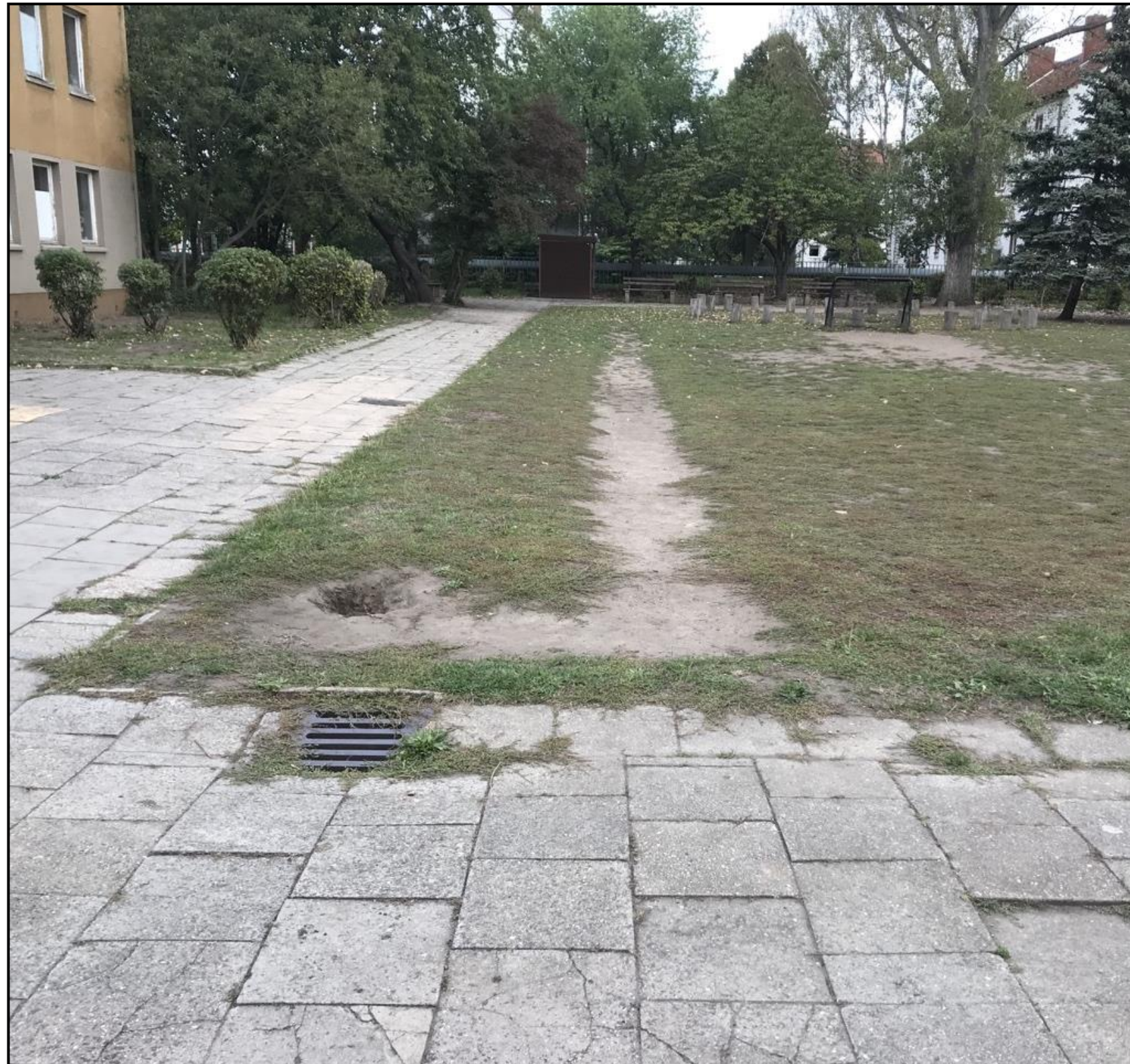
Innenhof westlicher Schultrakt, massiv geschädigte Belagsflächen und mangelhafte Oberflächenentwässerung
