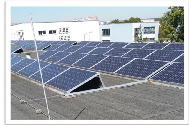
Photovoltaikanlage BBS II An der Schwimmhalle 3/6
