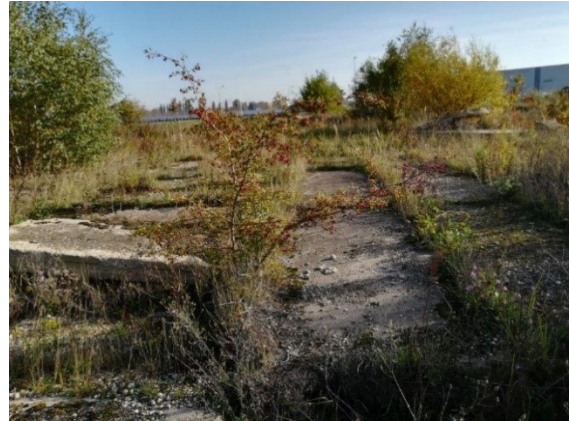
Abbildung 9: Häufiges Bild im Plangebiet; Betonbodenplatten mit Ritzen und emporkommender Vegetation (15.10.2019, Büro Schulz UmweltPlanung)
