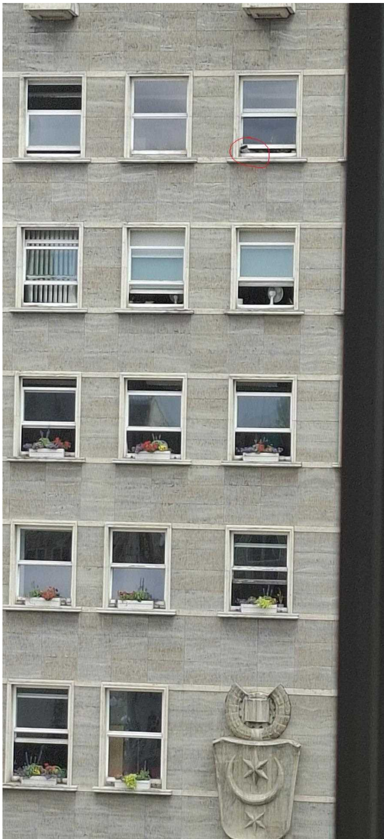
Deutlich sichtbarer Abluftschlauch des Klimagerätes aus dem Fenster des Büros im GB I (roter Kreis) Ende Juni
