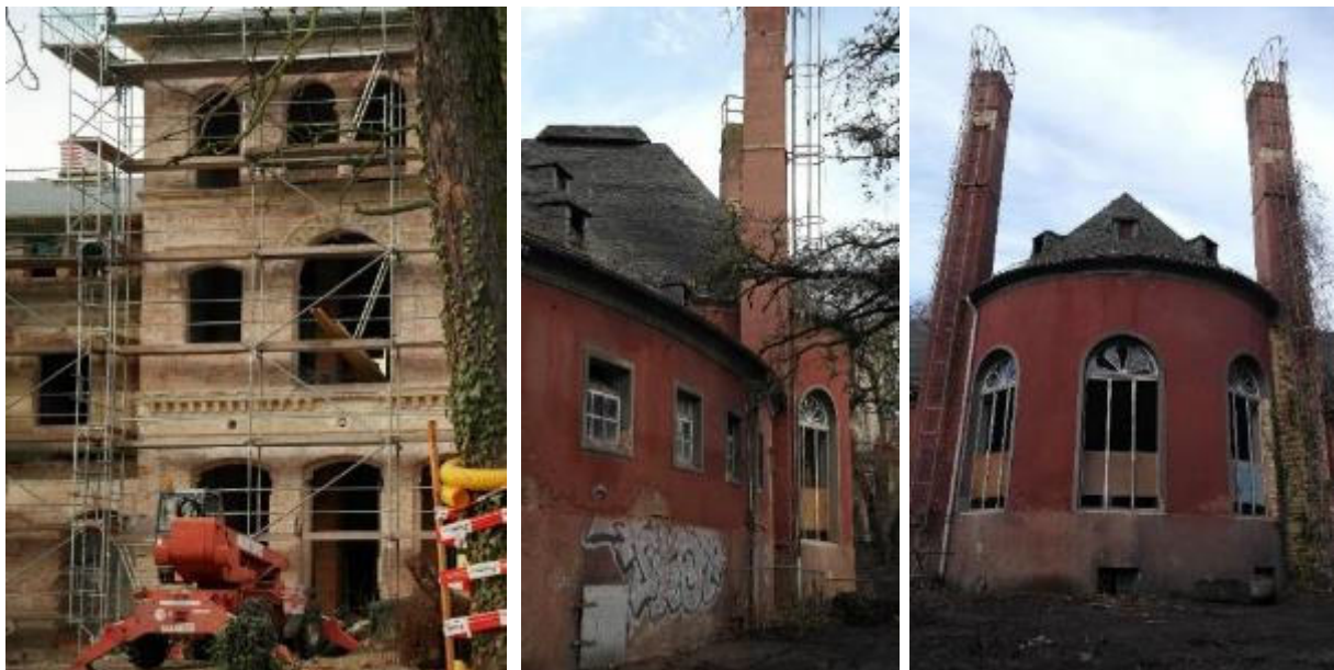
Abbildung 80: Sicherungsmaßnahmen am Gesellschaftshaus (Bild links) und Badehaus vor der Sanierung (Bild Mitte/Rechts)
